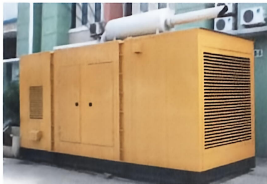
Gambar 2.10 Genset sebagai sumber listrik cadangan
