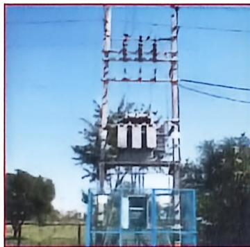
Gambar 2.6 Gardu tiang trafo tegangan menengah PLN
