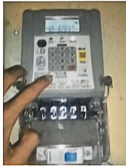
Gambar 2.1 Meteran listrik yang menggunakan pulsa
