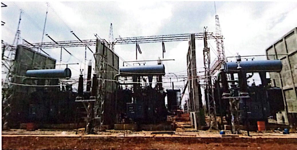
Gambar 2.7 Tiga Buah Transformator 1 fasa
